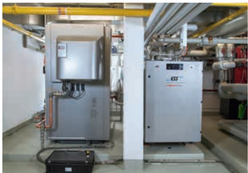
Die neue Strom- und Wärmezentrale
